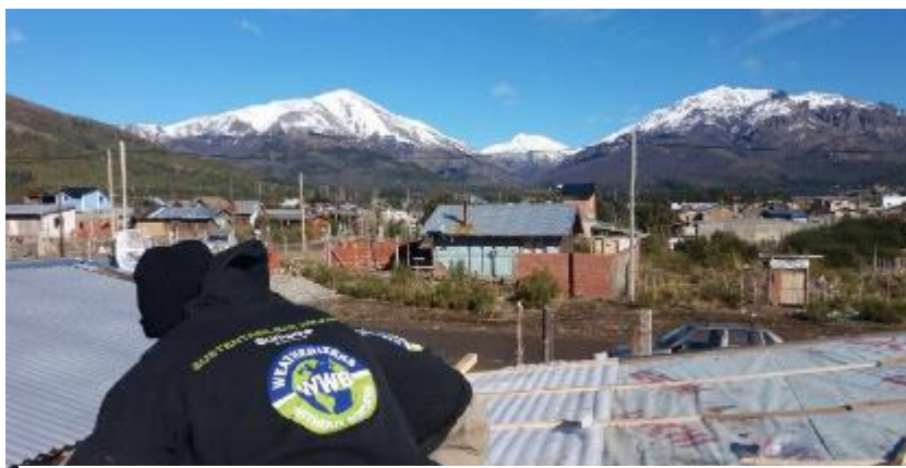
Titular durante la obra, mejorando la aislación del techo de una de las viviendas beneficiadas durante la etapa piloto en el barrio Nuestras Malvinas. Fuente: Municipalidad de San Carlos de Bariloche.
