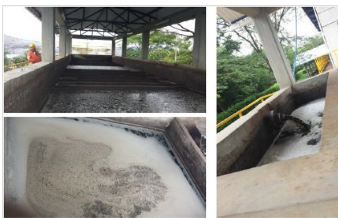
Tanques onde são realizados procesos primarios, de equalização e tratamento de lixiviados / Fonte: Poveda, F. (2015) Análisis del Plan Integral de Gestión de Residuos Sólidos "PGIRS", del municipio de Villavicencio, Departamento del Meta, en sus componentes: Implementación, Actualización, Seguimiento y Control. Facultad de Ciencias Contables, Económicas y Administrativas. Universidad de Manizales. Colombia p.118
