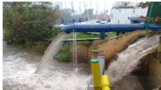
Estações de bombeamento das ravinas. Fonte: Município de San Isidro.
