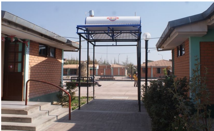
Terma solar instalada no Lar do Idoso. Fonte: Grupo10 Noticias Huancayo (web).
