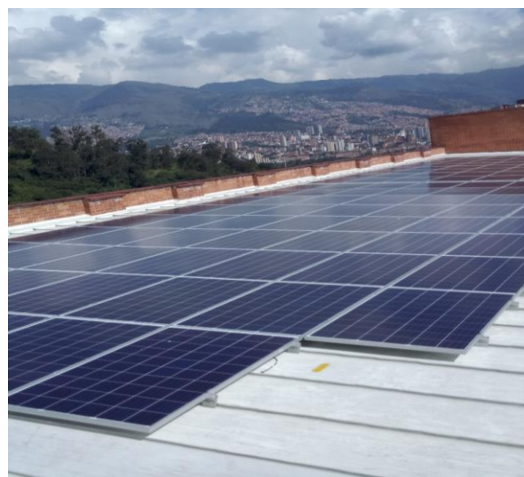
Paneles solares ubicados en la cubierta
