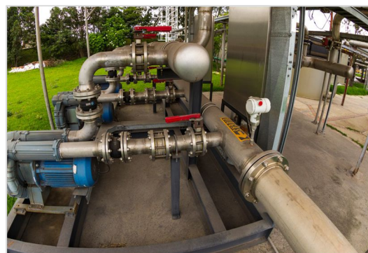
Sistema de aprovechamiento de biogás en la planta Tocancipá
